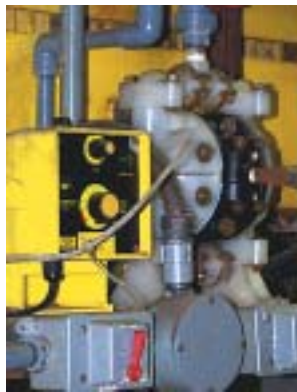
ARO 1/2" membránové čerpadlá prečerpávajú odpadovú vodu k chemickému čisteniu.
